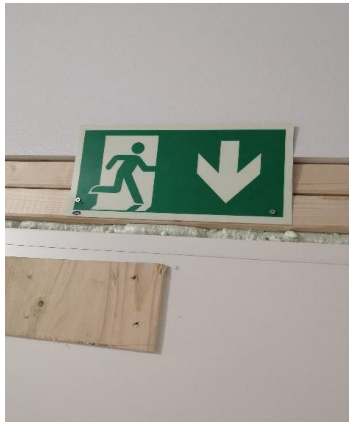
Viikon positiivinen työturvallisuushavainto Poistumistiemerkintöjä lisätty
